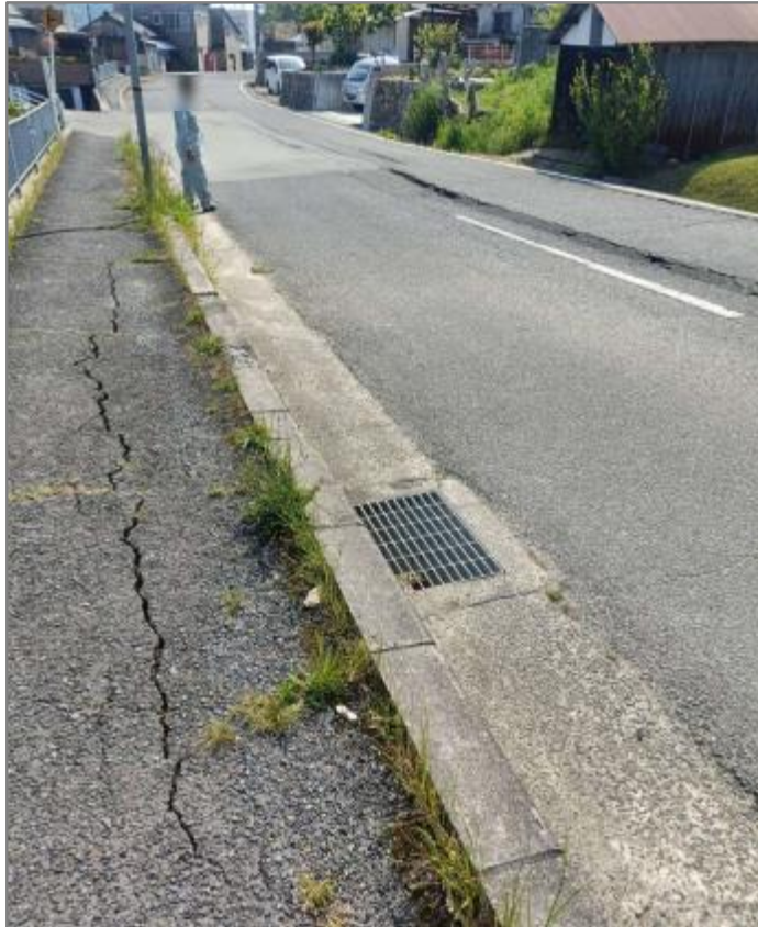
ひび割れ状況①
