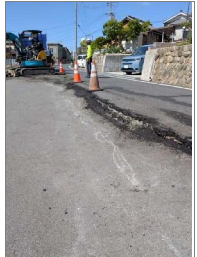
ひび割れ 拡大状況③
