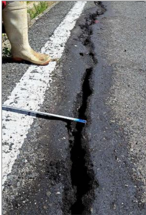
ひび割れ 拡大状況②
