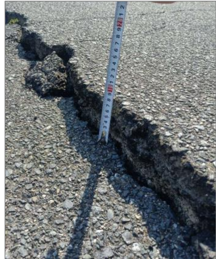
ひび割れ状況②(約10cm)
