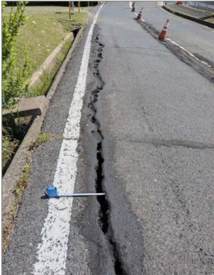
ひび割れ 拡大状況①
