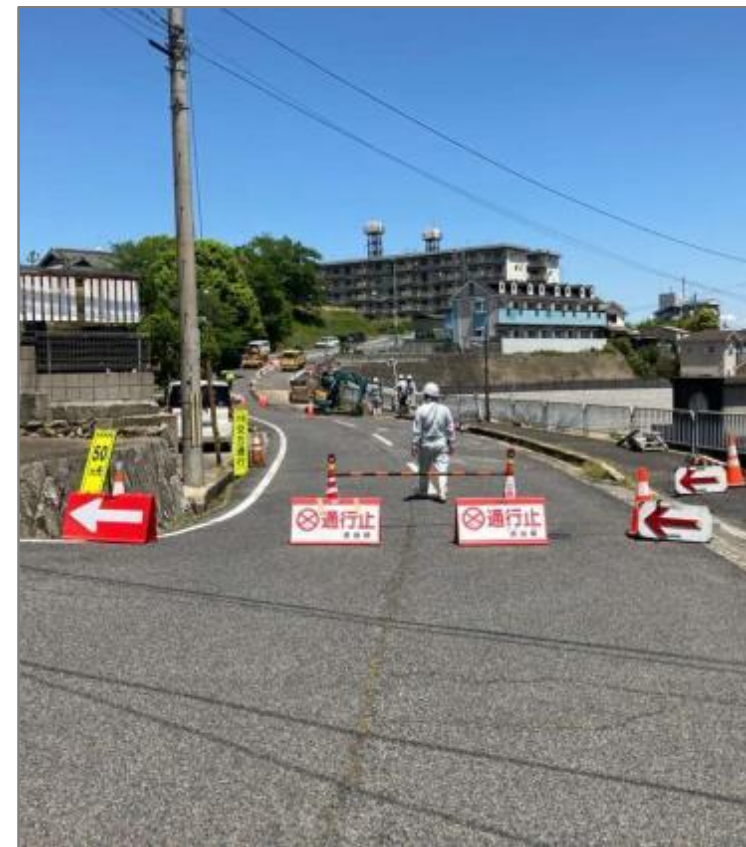
全面通行止状況 (5月8日 12時～)
