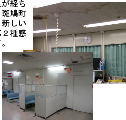
●老朽化した病院内部(天井に雨漏りも)
