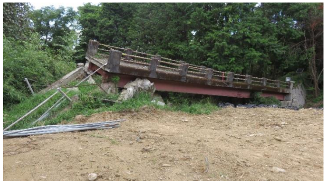
写真5. 押し寄せた土砂により橋梁が被災した様子
